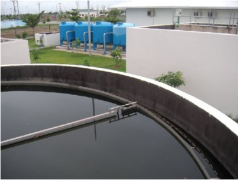
団地内の廃水処理施設
