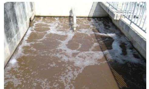
生物分解をする曝気槽
