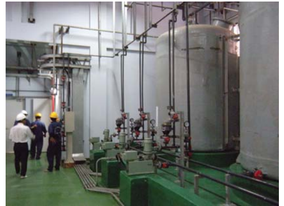
塩素により消毒後、河川へ放流
