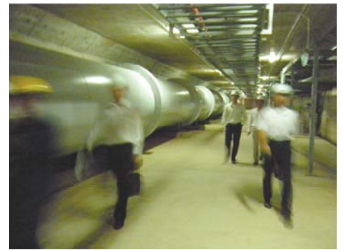
微生物を活性化させるために曝気槽へ空気を送るパイプ
