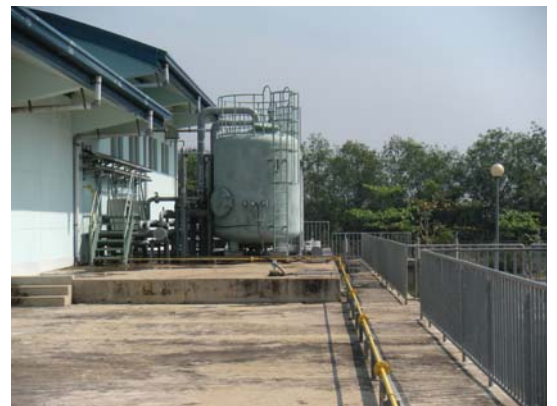
塩素を消毒槽へ送る(黄色い配管)
