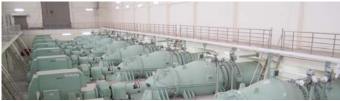
イエンソー・ポンプ場
