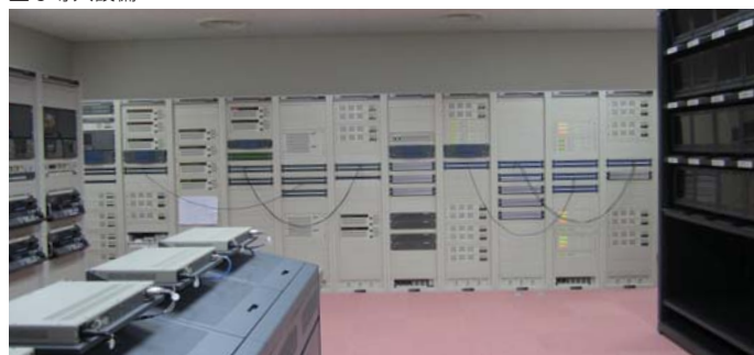
主な導入設備
