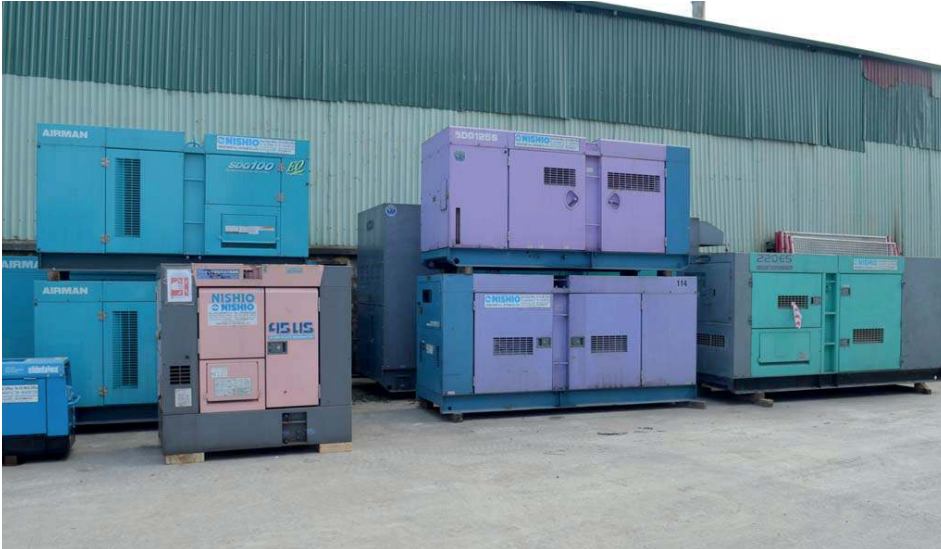
しっかりとメンテナンスされた各種発電機
