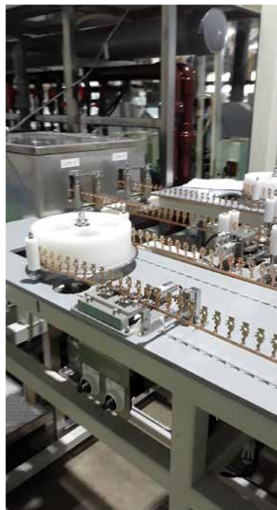
▲自動生産ライン制御システム
