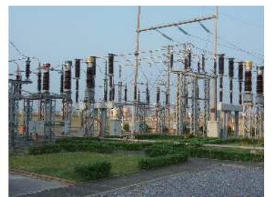
Thien Ke 変電所 (110Kv)
