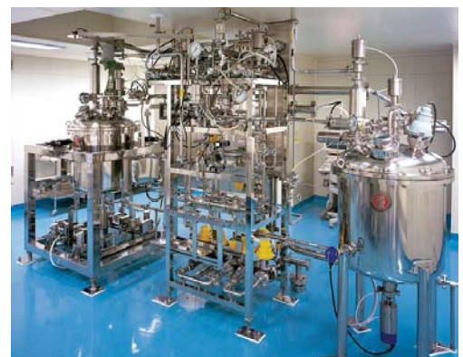
医薬プラント設備
