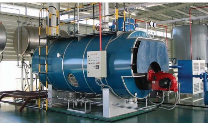
プラント付帯設備
